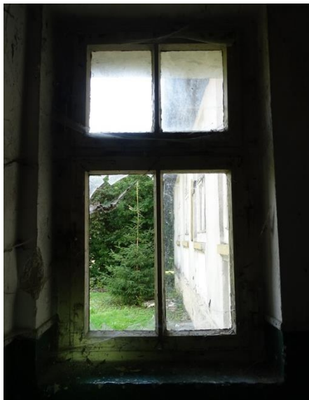
Abb. 27: Einflugmöglichkeit durch kaputte Fensterscheiben in Fabrikgebäude Kirchstraße 37.
