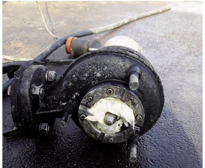
Verstopfter Pumpeneinlass mit blockiertem Laufrad
