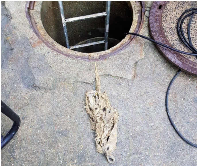
»Zopf« aus Feuchttüchern aus einem Hausanschlusskanal
