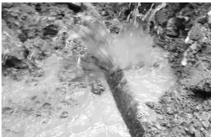
Ein Wasserrohrbruch sorgt für eine sprudelnde Quelle
