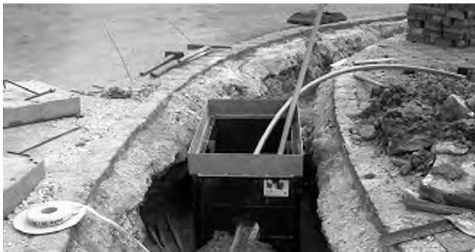
Leerrohre mit Glasfaserkabel sorgen für schnelles Internet
