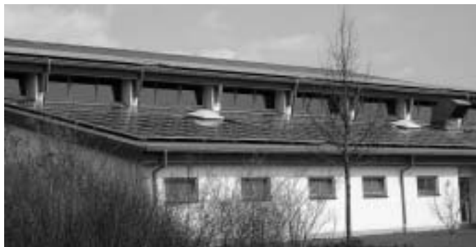
Eine von 90 Anlagen in der Gemeinde: Die PV-Anlage auf dem Dach der Alb-Sporthalle in Böhmenkirch
