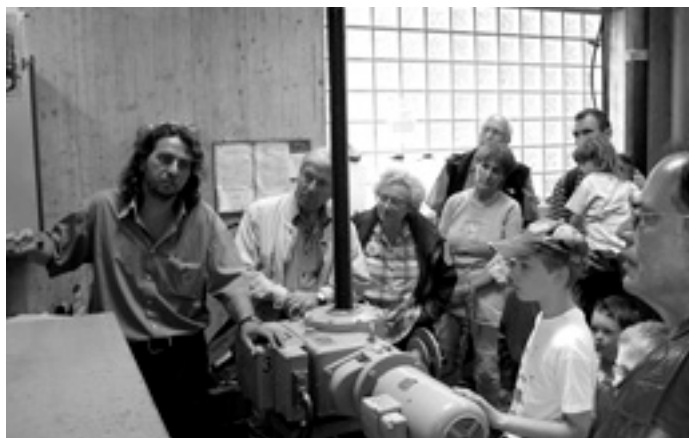
Betriebsbeauftragter Markus Bachofer erklärt im Schieberhaus die Funktionsweise der technischen Einrichtungen.
